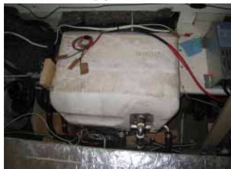
温水ボイラー
