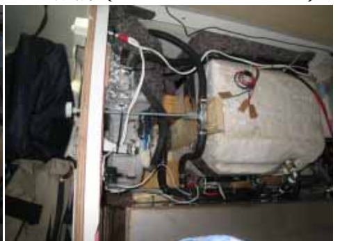
ボイラー熱源切替 (ラジエーター/AC100V)
