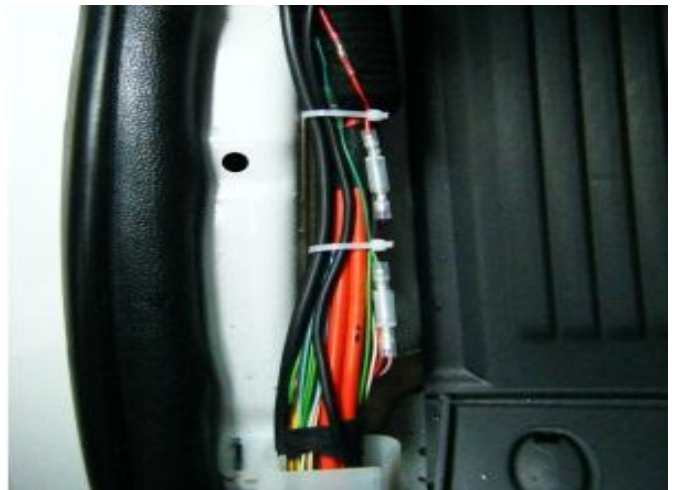
カバーを外すと「ピンク/紫」の線が あるので切断しル-へ
